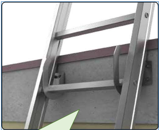
Accesso per manutenzioni frequenti + DPI anticaduta e ancoraggi fissi
