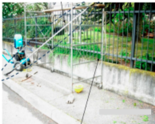
Trabattello montato in modo incompleto
