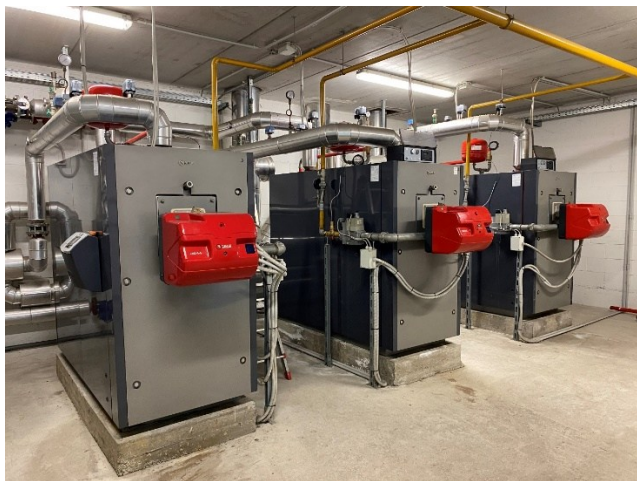
Figura 1 impianto centrale di riscaldamento, con vasi di espansione chiusi, servito da generatori di calore.
