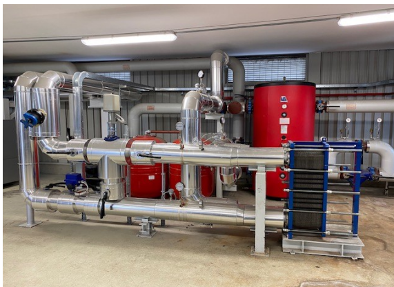
Figura 2 impianto centrale di riscaldamento, con vasi di espansione chiusi, servito da scambiatore di calore
